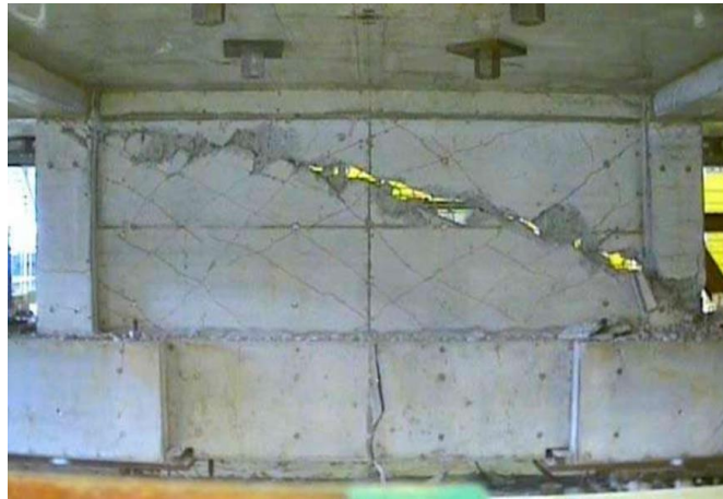
شکل ۱۱ شکست برشی دیوار در بارگذاری Run 5
